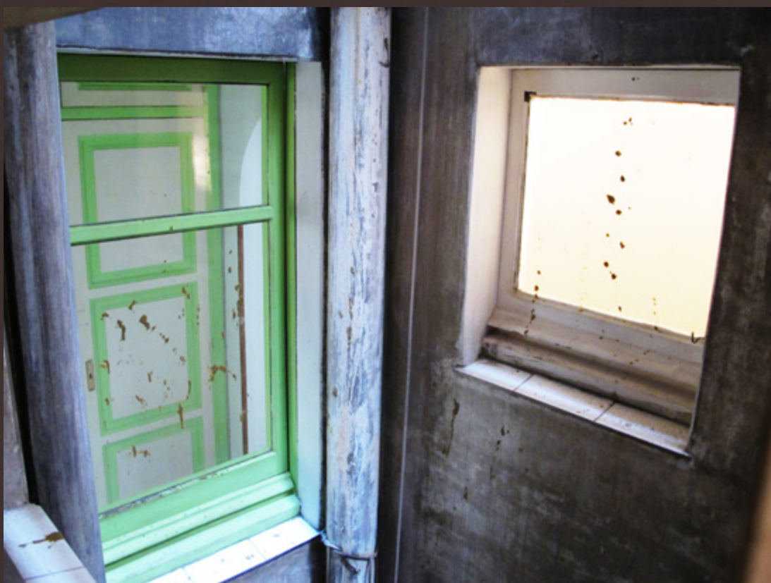
Restes d'excrements degut al mal estat dels baixants
