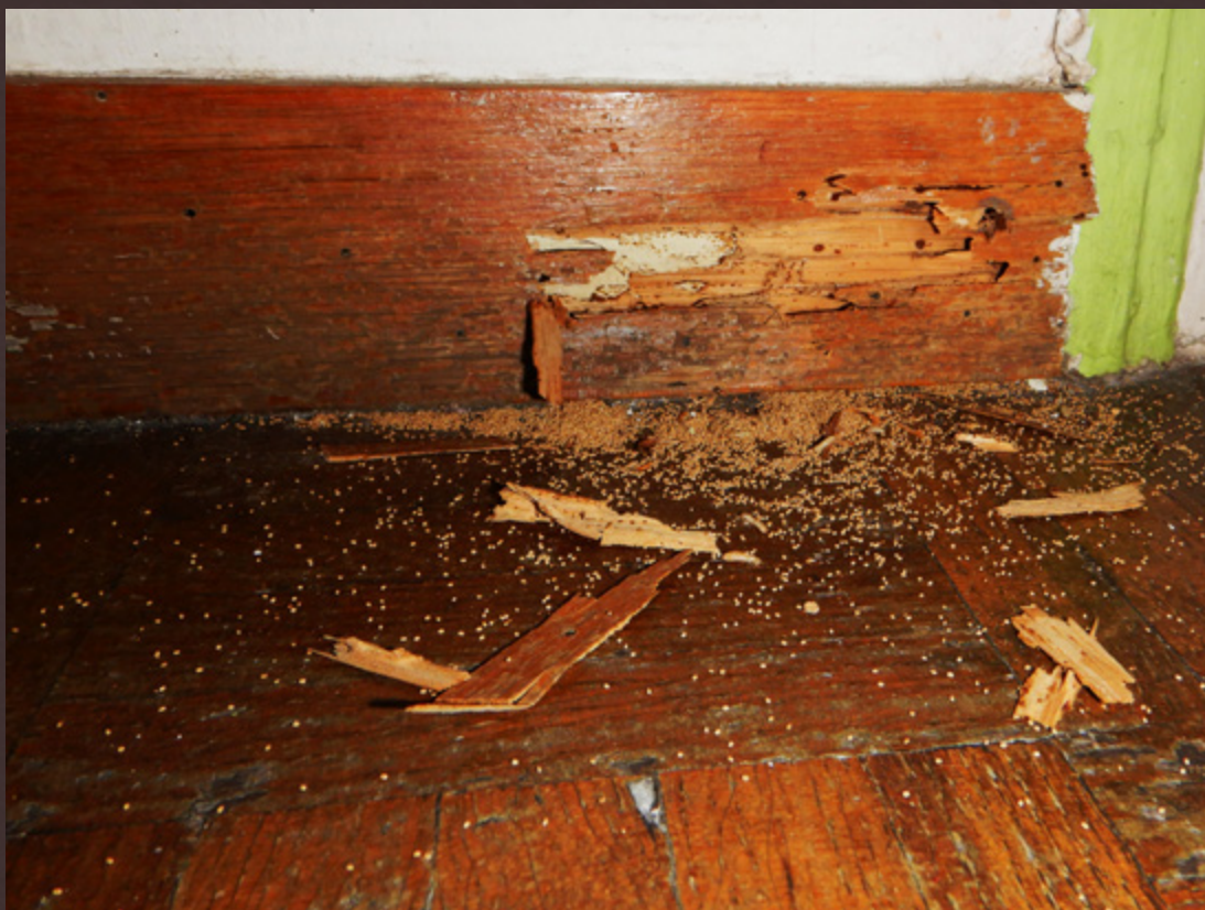
Plaga de termites
